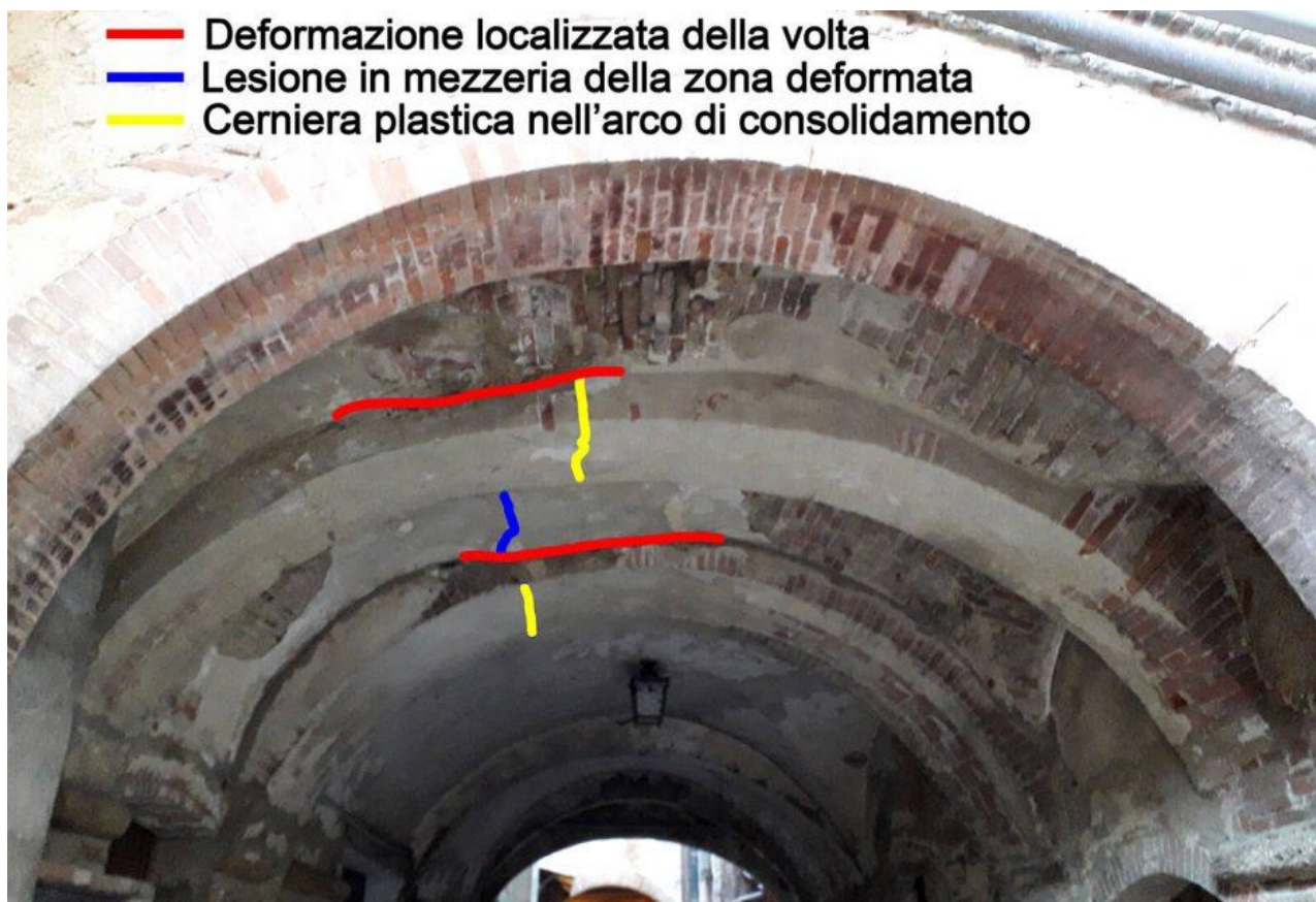
Fig. 15 – Dissesto di una volta botte per instabilità del campo centrale, successivamente contrastato mediante la costruzione di due arconi di rincalzo: il dissesto si è riformato perché non è cambiata la configurazione strutturale
