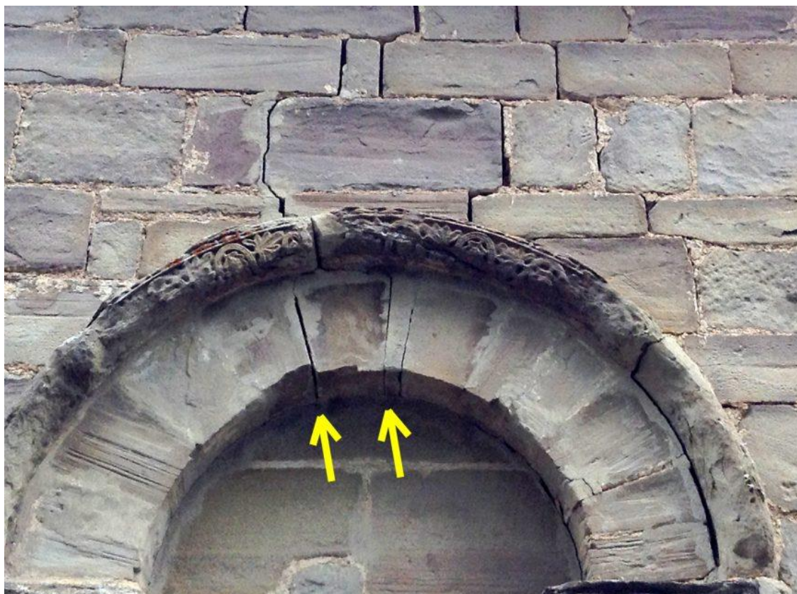
Fig. 9 – Dissesto a taglio in fase precoce: si notino il lieve scorrimento verso il basso del concio in chiave (freccie gialle) e la lesione parabolica nella muratura soprastante, un chiaro indizio dell’innalzamento della curva delle pressioni
