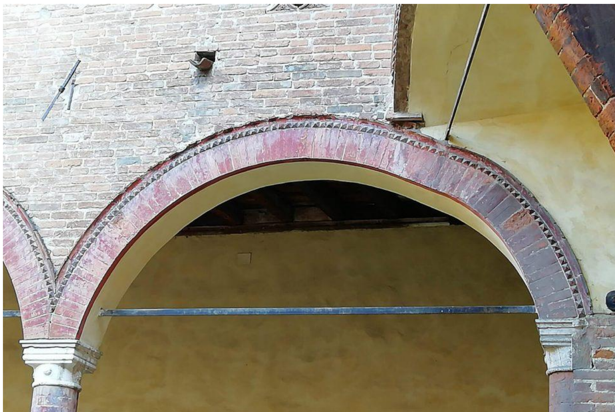
Fig. 14 – Ferrara, cortile interno di Casa Romei (XV secolo): esempio di arco con vistosa deformazione localizzata per la presenza di un carico concentrato in posizione asimmetrica
